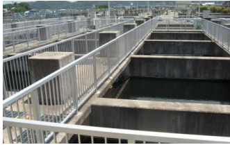
下水処理場 Sewage treatment plant
